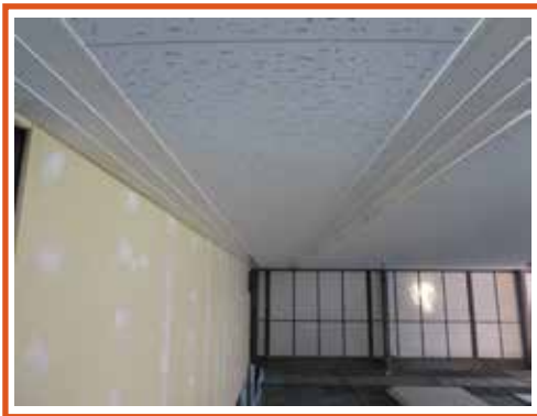
耐震天井廻り縁
